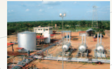
ベネズエラ原油処理プラント
