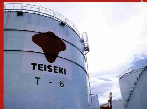
T-6第1石油類タンク
