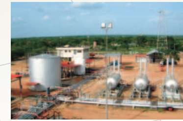
ベネズエラ原油処理プラント
