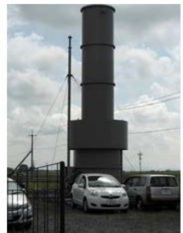
秋田鉱業所新堀集油所 グラウンドフレア
