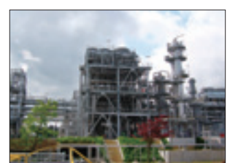
ガス処理プラント・新規系列
