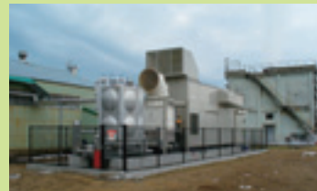
天然ガスコージェネレーションシステム
