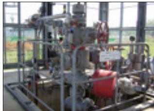
関原ガス田 圧入排出井
