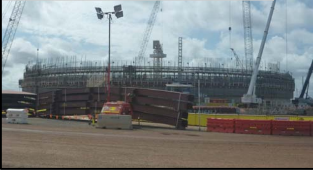
LNG storage tank in Onshore LNG plant (Apr. 2014, in Darwin)
