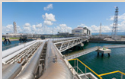
Naoetsu LNG Terminal
