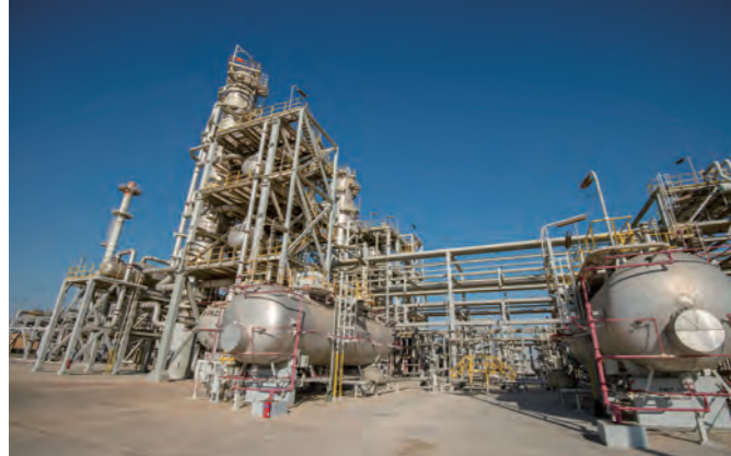
ADCO鉦区の生産施設
