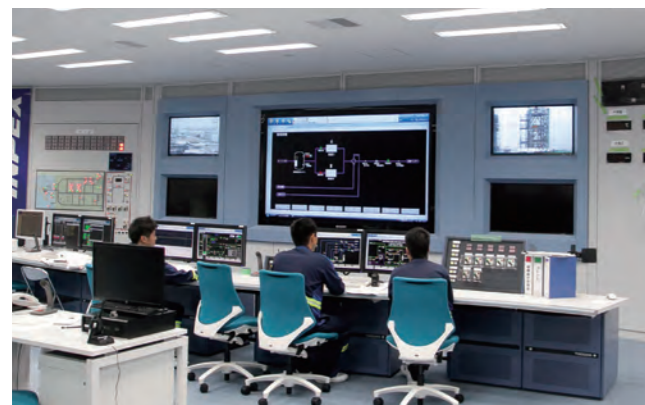
直江津LNG基地での初のLNG受入 LNG受入作業の様子(上)とこれを見守る中央監視室(下)
