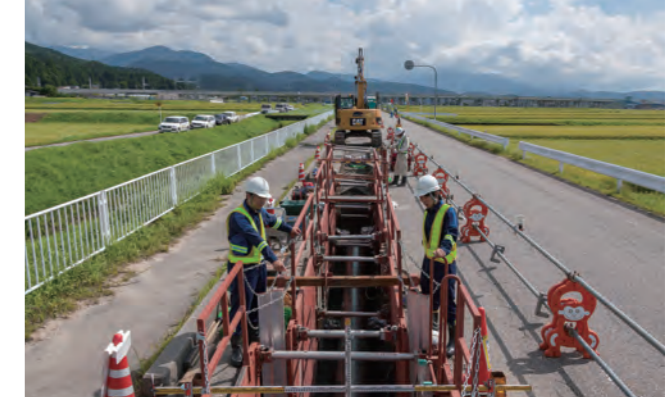
立山山系を背景にライン埋設工事が進む(富山県朝日町地内)
