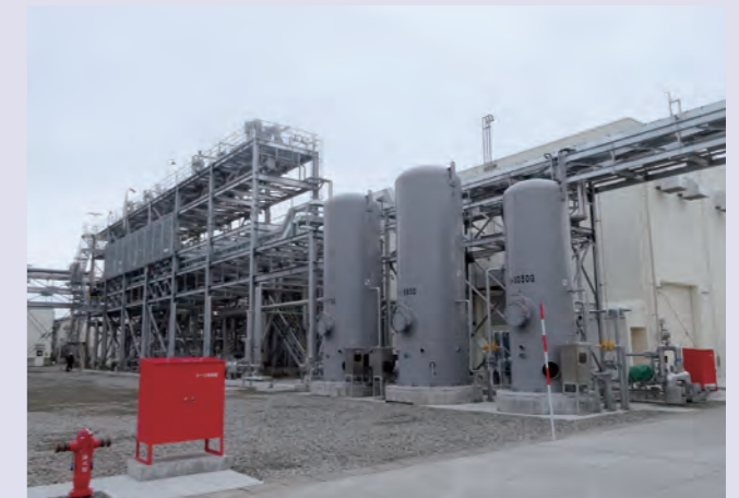
稼働を開始した南長岡ガス田越路原プラントの低圧採取設備
