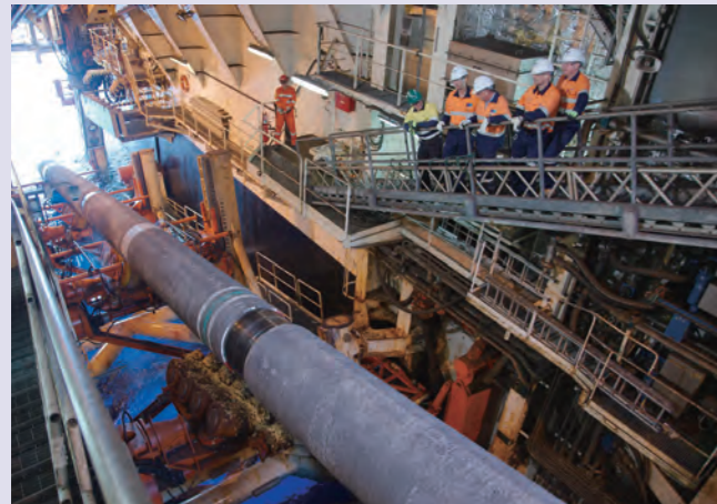
イクシスLNGプロジェクト、ガス輸送パイプライン敷設作業開始
