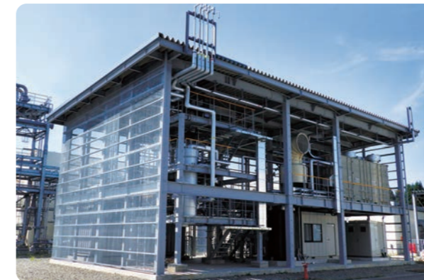
越路原プラント内のメタネーション実証設備
